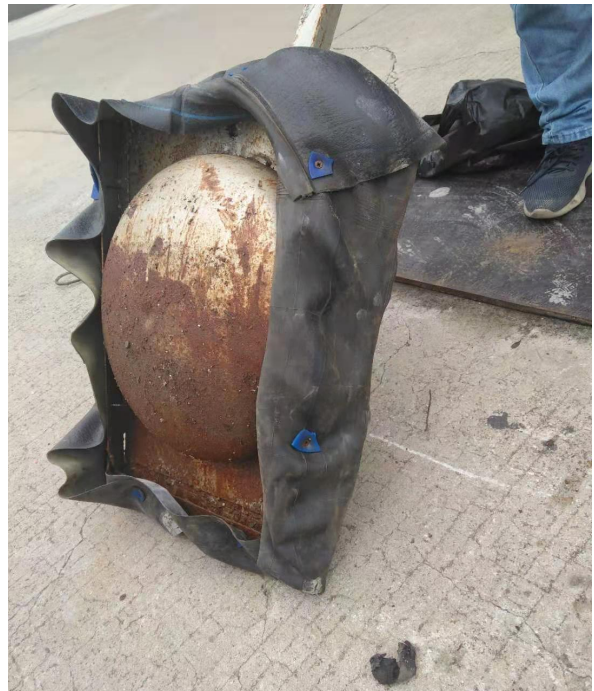
图 7 雨水闸门内部
