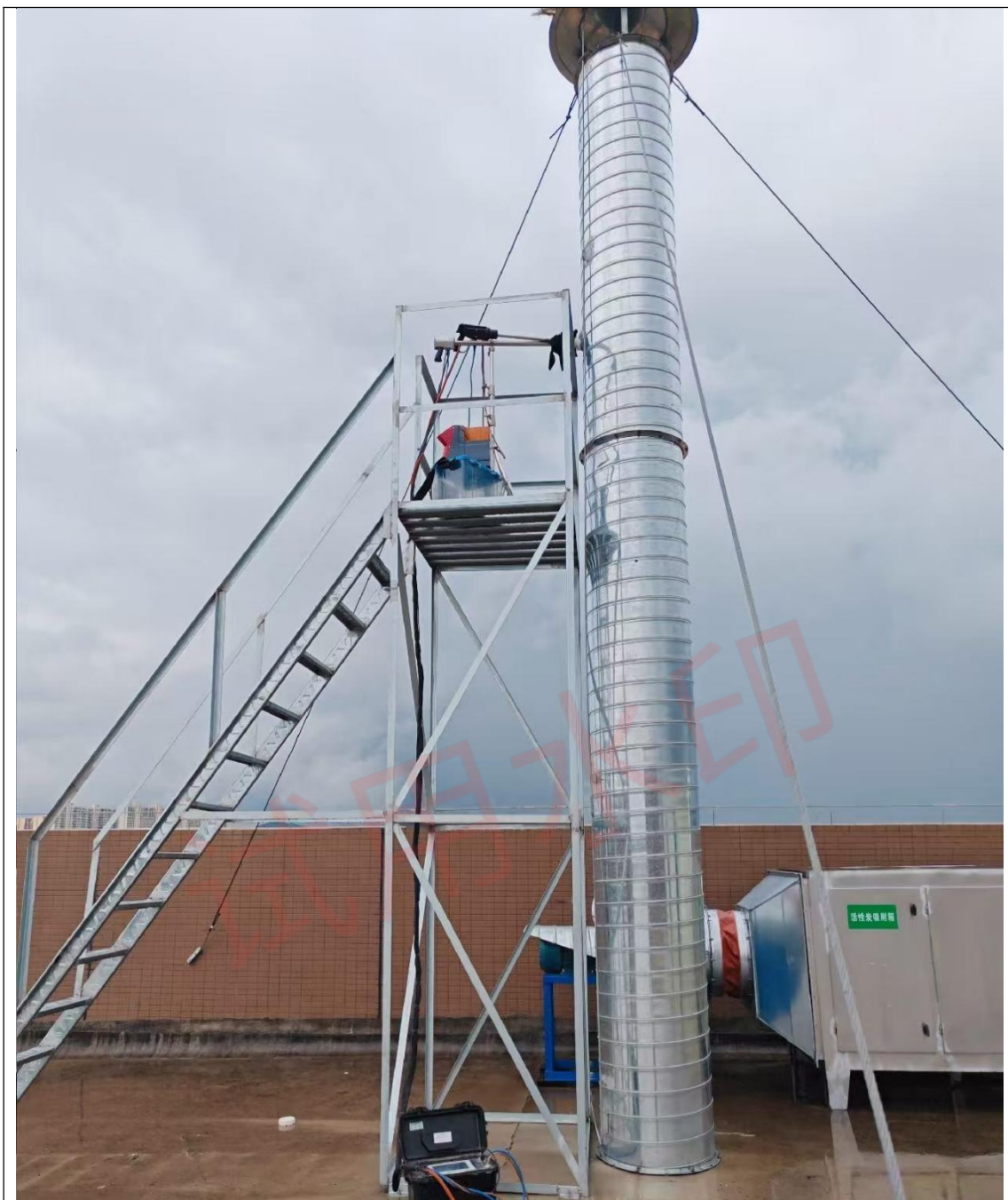
废气治理设施
