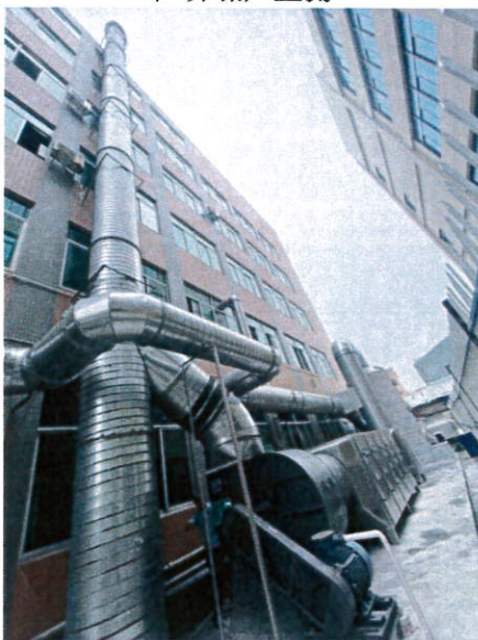
废气治理设施
