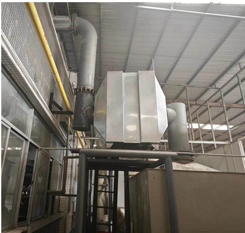
图 7.2-1 现有项目冷凝器设备现场照片
